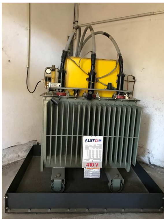
Vue du transformateur à huile sans PCB qui va être mis hors service et retiré
