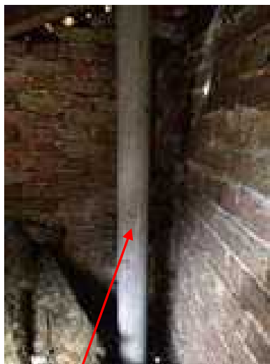
Conduit de fumées en amiante (combles)
